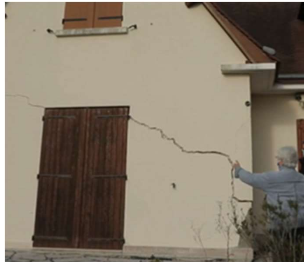
Apparition de fissures caractéristiques
